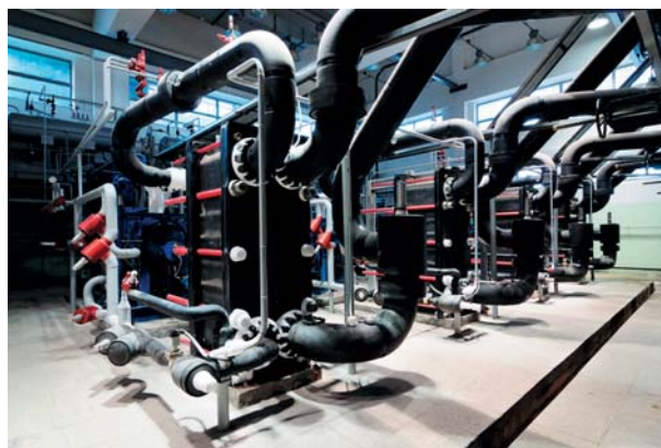
Хладоцентр комплекса «СНЕЖ.КОМ»
