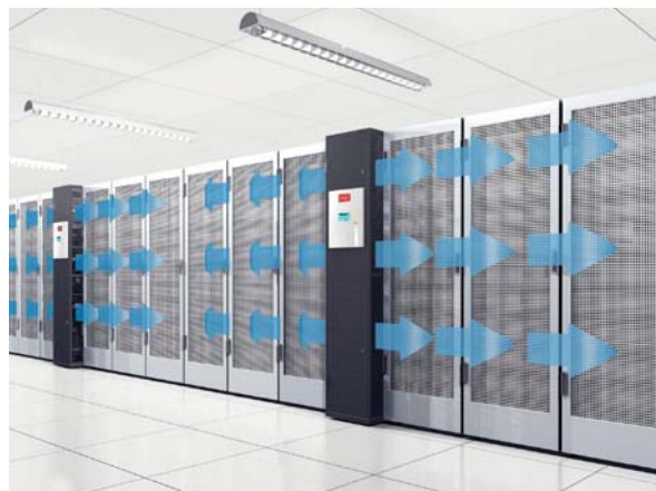
Рис. 5. Внутрирядные кондиционеры CyberRow от компании Stulz выдувают воздух не прямо, а влево и вправо — вдоль фронтальных дверей ИТ-стоек
